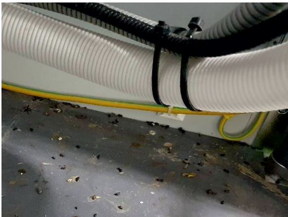
Rys. 3. Odchody myszy na podłodze szafy zabezpieczeniowej
