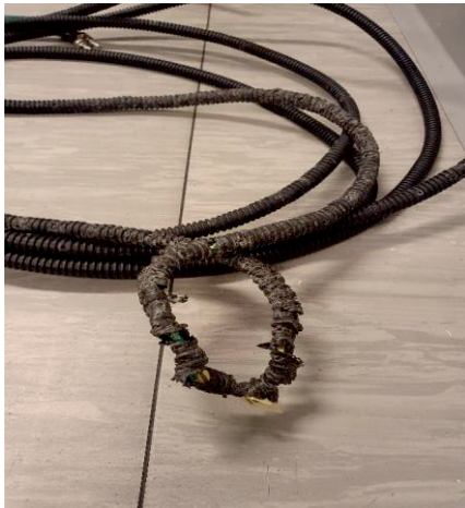
Rys. 2. Przegrzany światłowód wraz z peszlem ułożony pod podłogą technologiczną
