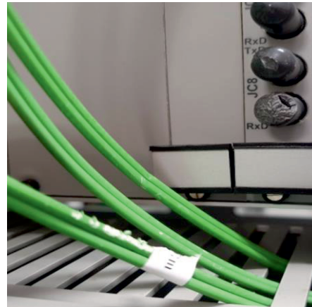
Rys. 3. Uszkodzona izolacja światłowodów
