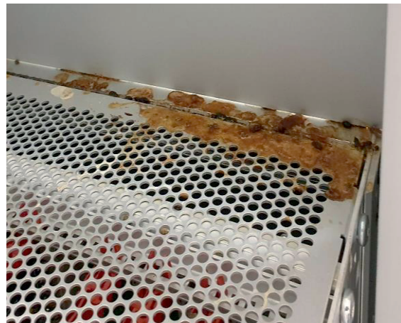
Rys. 4. Odchody myszy na kasce automatyki zabezpieczeniowej
