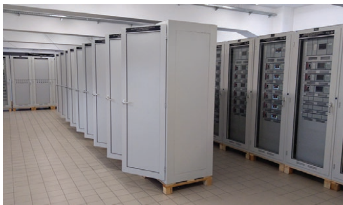
Rys. 4. Szafy zabezpieczeń Grudziądz Węgrowo
